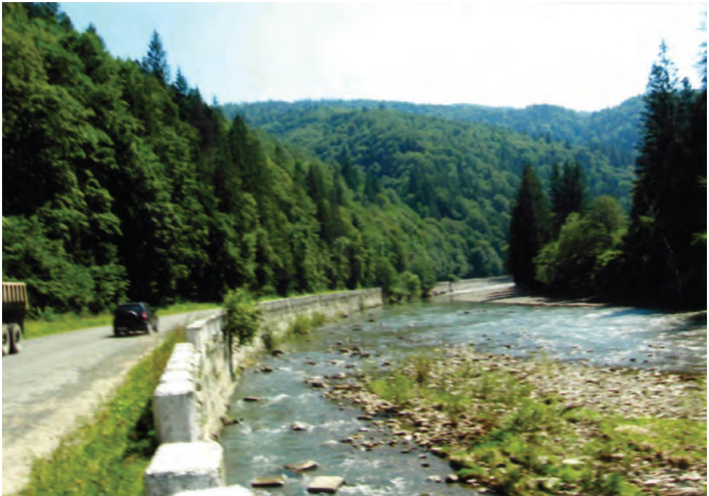
Рис. 4 – Залізобетонні берегові кріплення – підпірні стінки на р. Опір після повені 23-28 липня 2008 р.
