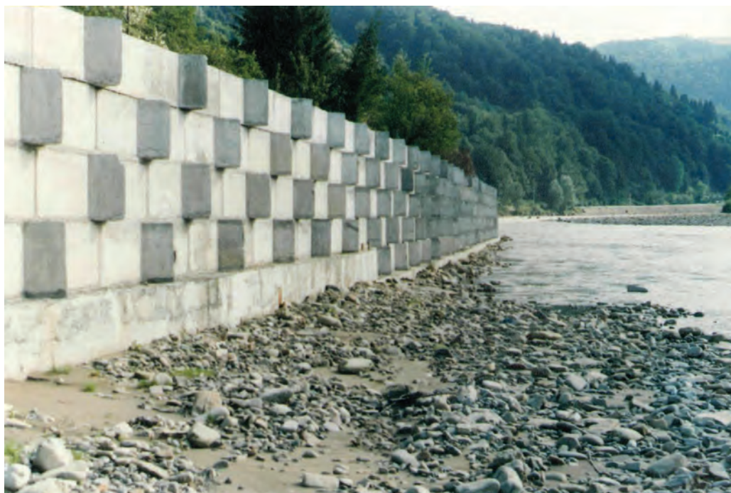
Рис. 7 – Залізобетонні кріплення на правому березі р. Черемош у районі с. Хорови Путильського району Чернівецької області
