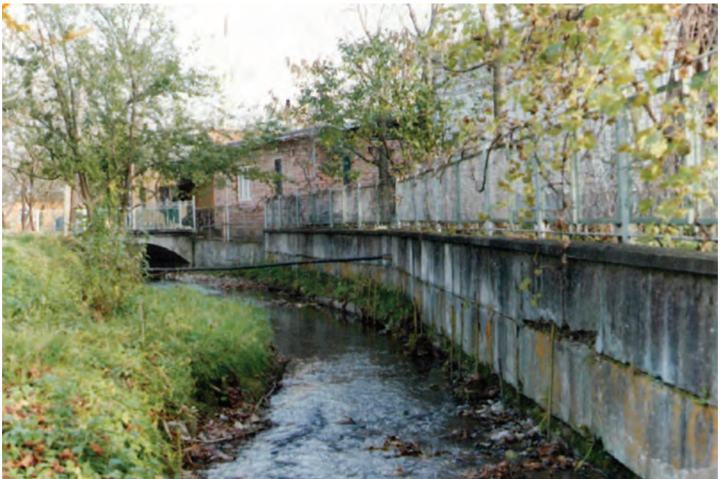
Рис. 5 – Залізобетонне берегове кріплення – підпірна стінка з тривалим терміном експлуатації (40 років) на малій гірській річці Потік – лівій притоці р. Черемош у с. Старі Кути Косівського району Івано-Франківської області
