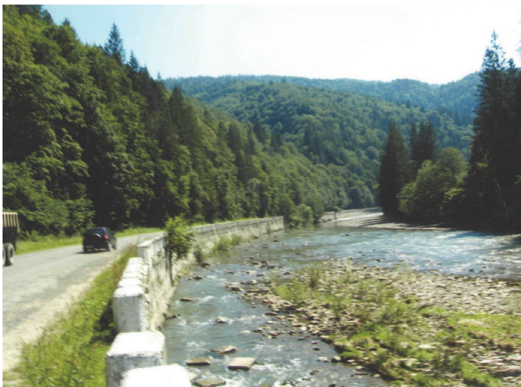
Рис. 4 – Залізобетонні берегові кріплення – підпірні стінки на р. Опір після повені 23-28 липня 2008 р.
